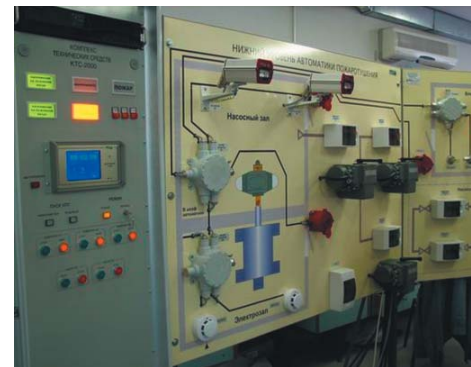
Рис. 8. Тренажер пожарной автоматизации
